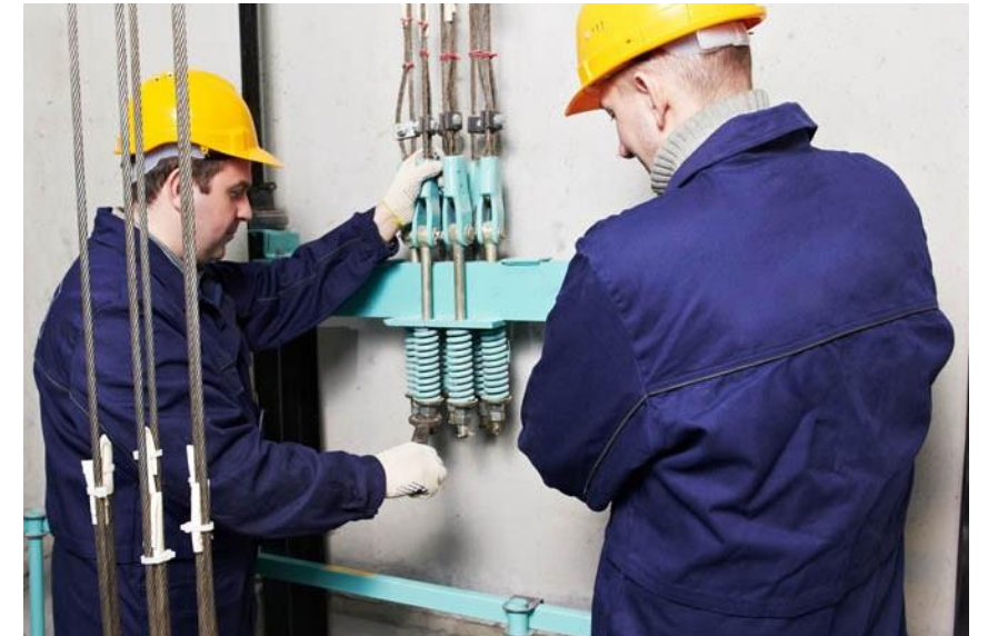
Mantenimiento preventivo y correctivo
